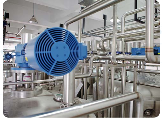
▲空調の熱負荷予測でも成果を上げている(写真はイメージ)
